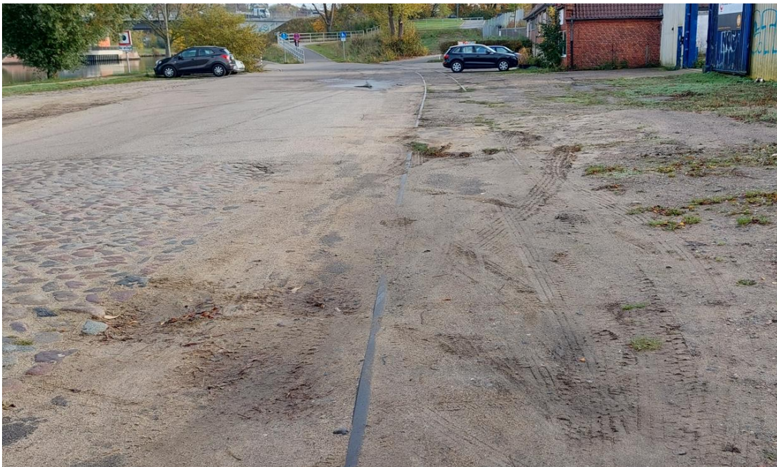
Abb. 10: Blick nach Nordosten - Höhe Geniner Ufer 1 und 2. Im Hintergrund ist die Possahlbrücke zu erkennen.
