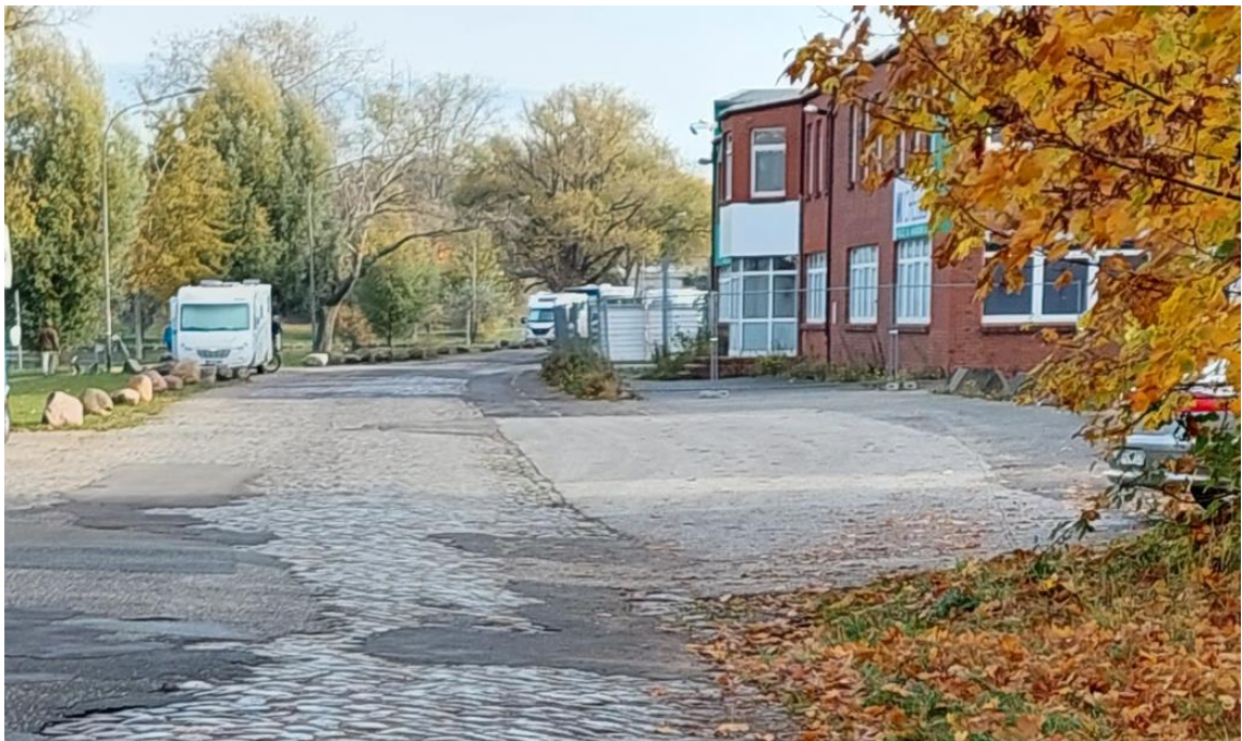
Abb. 6: Blick nach Nordosten - Höhe Geniner Ufer 5-6 (Bauabschnitt 1). Im rechten Bildrand, im Bereich des Parkplatzes, sind die Gleise scheinbar aufgehoben worden. Im weiteren Verlauf sind die Gleise vor dem Gebäude wieder zu erkennen. Die Straße besteht aus Kopfsteinpflaster, teilweise mit einer Asphaltdecke versehen.
